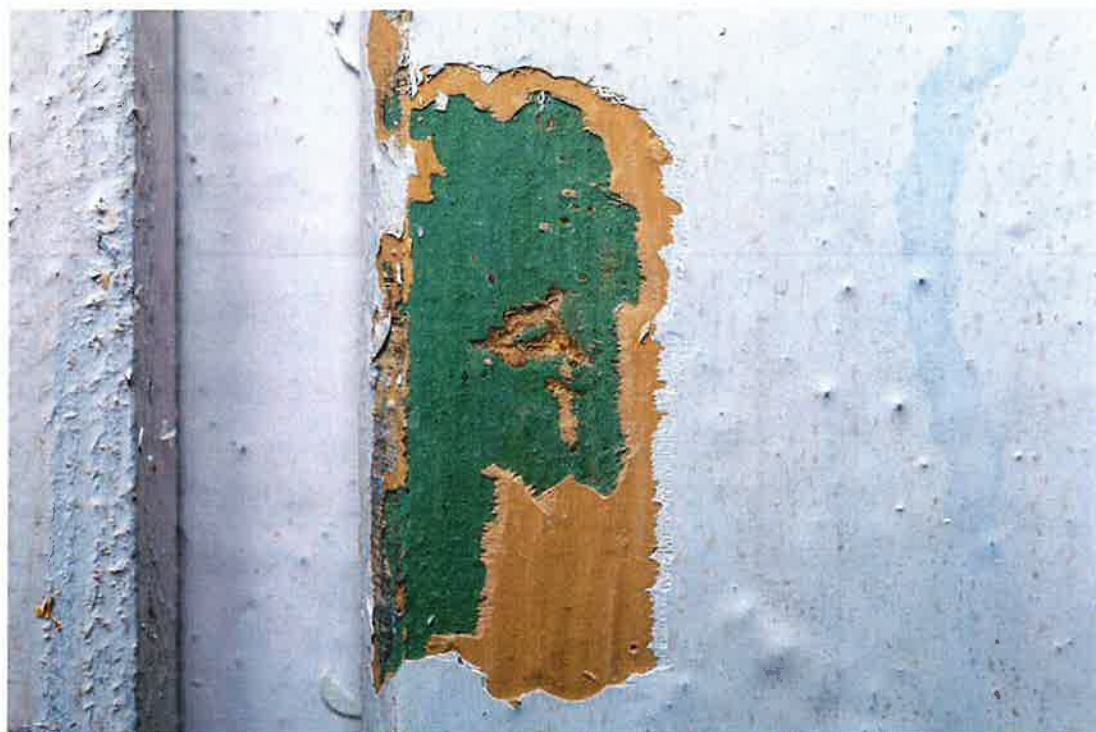
Fot. 30. Odkrywka nr 10 na skrzydle drzwi po prawej stronie ambony – tutaj pierwsza chronologicznie warstwą jest zielona, która na innych elementach jest warstwa kolejną.
