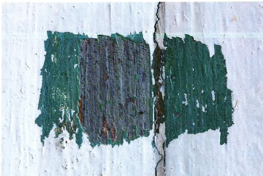
Fot. 13. Odkrywka nr 3 na słupie empory. Pomiędzy zaobserwowanymi w pozostałych odkrywkach warstwami malarskimi: najstarszą szarą a kolejną w kolorze chłodnej zieleni zaobserwowano cienką (widoczną przede wszystkim na przekroju) warstwę w kolorze ciepłej zieleni.
