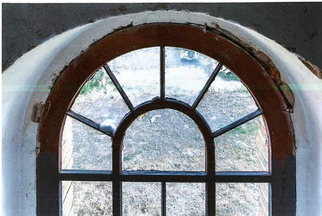
Fot. 35. Okna, które częściowo przysłania empora (czyli zachodnie okna w obu ścianach) przemalowano tylko częściowo.
